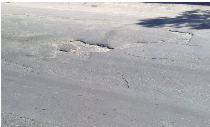
شکل ۱. خرابی روسازی (برآمدگی)، بلوار جهاد، ۲/۳ × ۳/۱ متر
